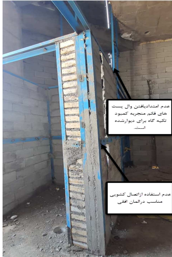
شکل ۴-۱۱ تکیه گاه نامناسب دیوار
