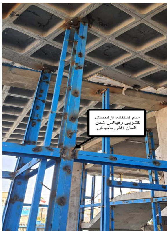
شکل ۴-۸ عدم استفاده از اتصال کشویی برای مهار وادار قائم
