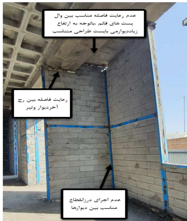
شکل ۴-۱۴ عدم رعایت جداسازی صحیح دیوار از طرفین
