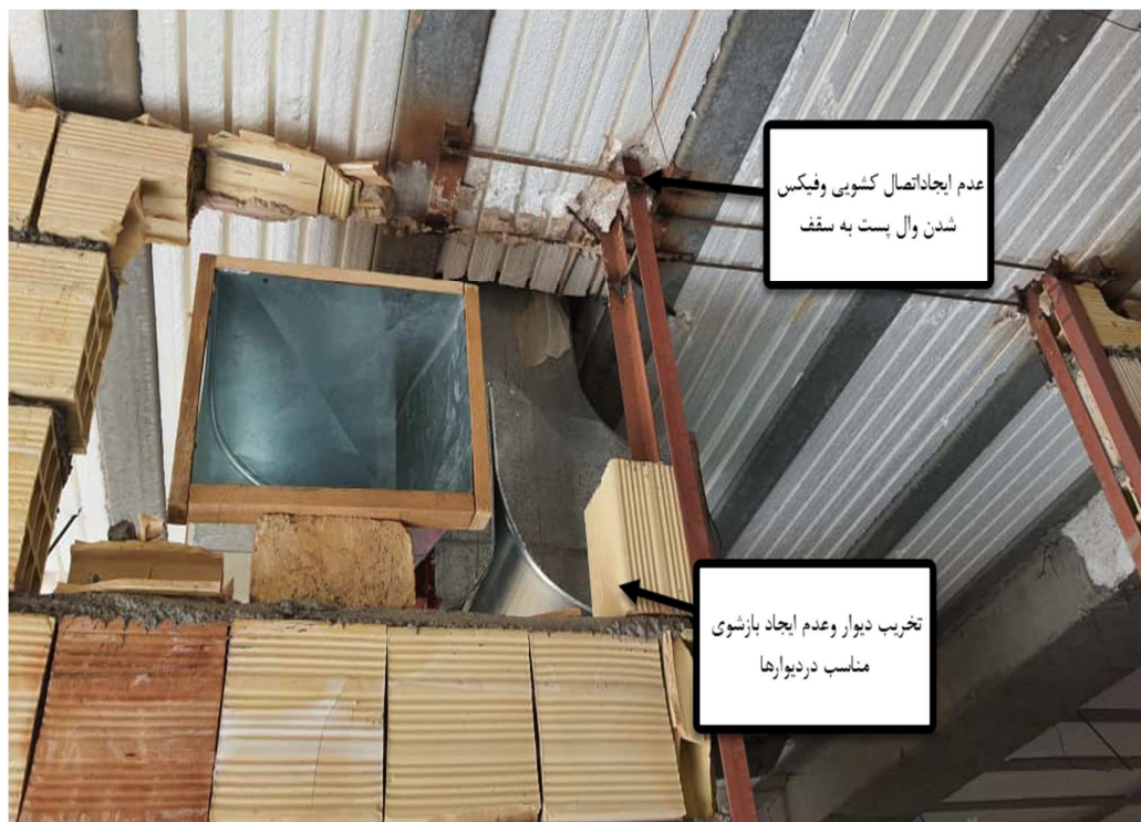
شکل ۳-۴ اجرای نامناسب دیوار داخلی
