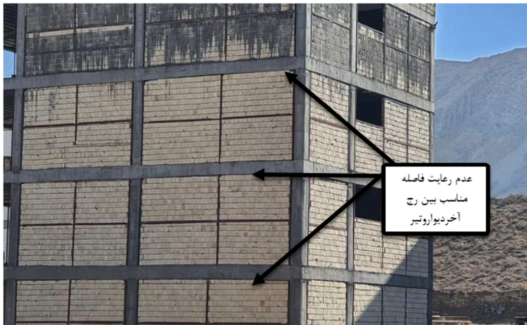
شکل ۴-۶ عدم رعایت جداسازی صحیح دیوار از اطراف
