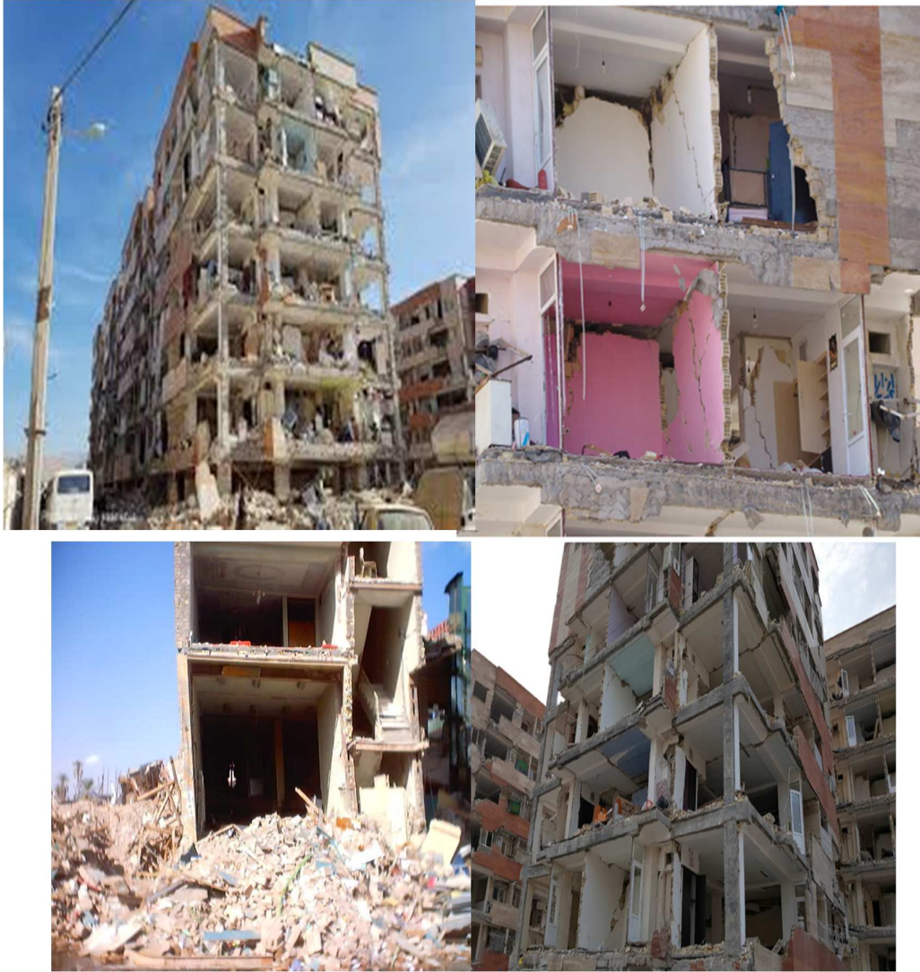
شکل ۱-۷ خسارات گسترده اجزای غیرسازه ای در زلزله ورزقان
