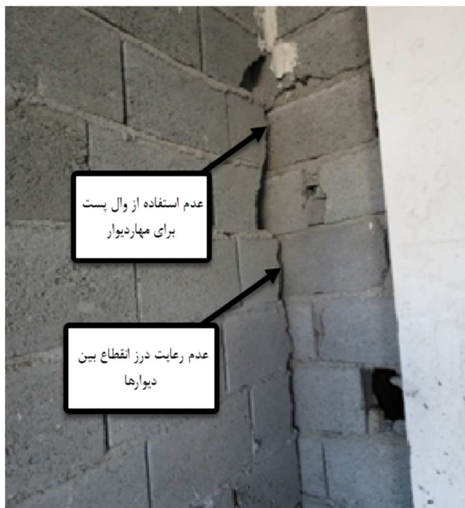
شکل ۴-۲۱ عدم جداسازی صحیح دیوار
