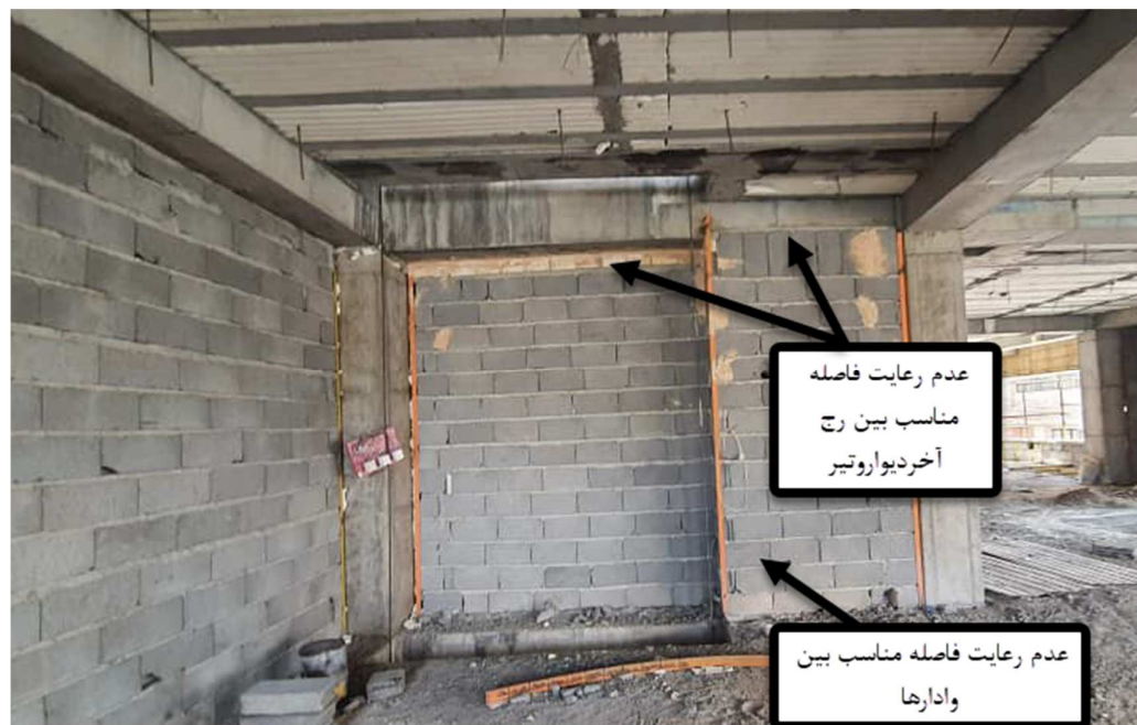
شکل ۴-۴ عدم رعایت جداسازی صحیح دیوار از اطراف
