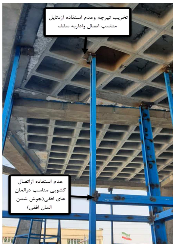
شکل ۱۷-۴ عدم استفاده از اتصال صحیح برای تکیه سقف
