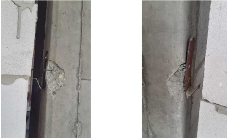
شکل ۳-۲۰ اتصال نامناسب در سازه های بتن مسلح
