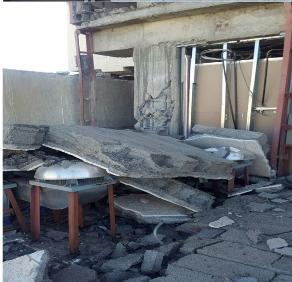
شکل ۴-۳۴ اتصال نامناسب وال پست به کف و سقف زلزله کرمانشاه
