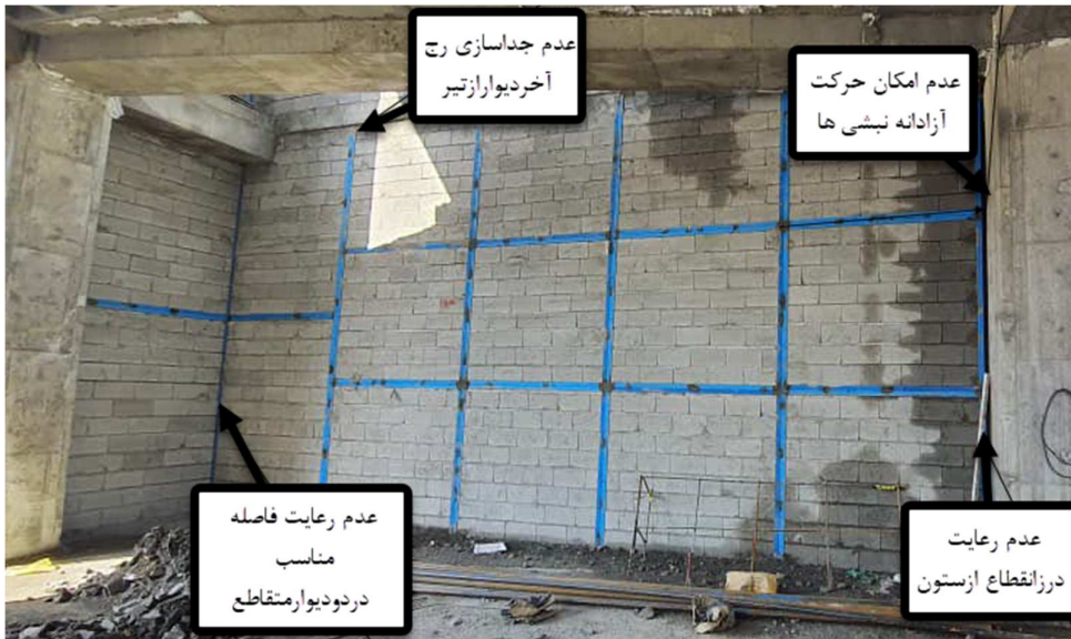
شکل ۴-۱ عدم رعایت جاسازی صحیح دیوار از اطراف
