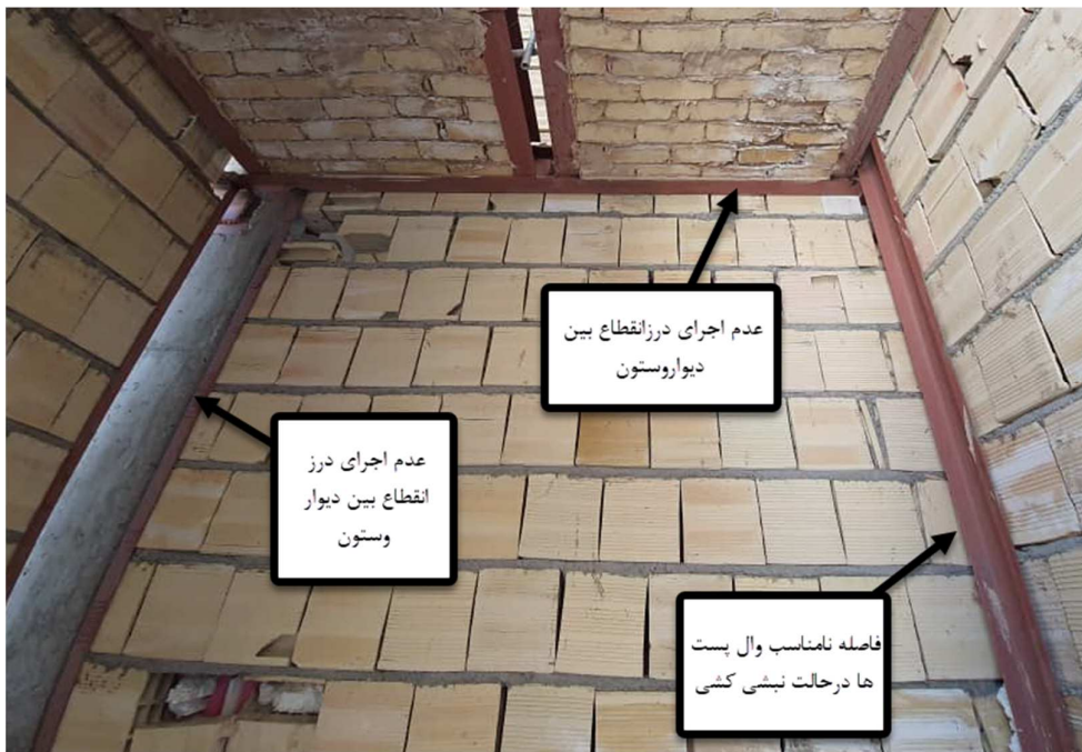
شکل ۴-۲ عدم رعایت جاسازی صحیح دیوار از اطراف
