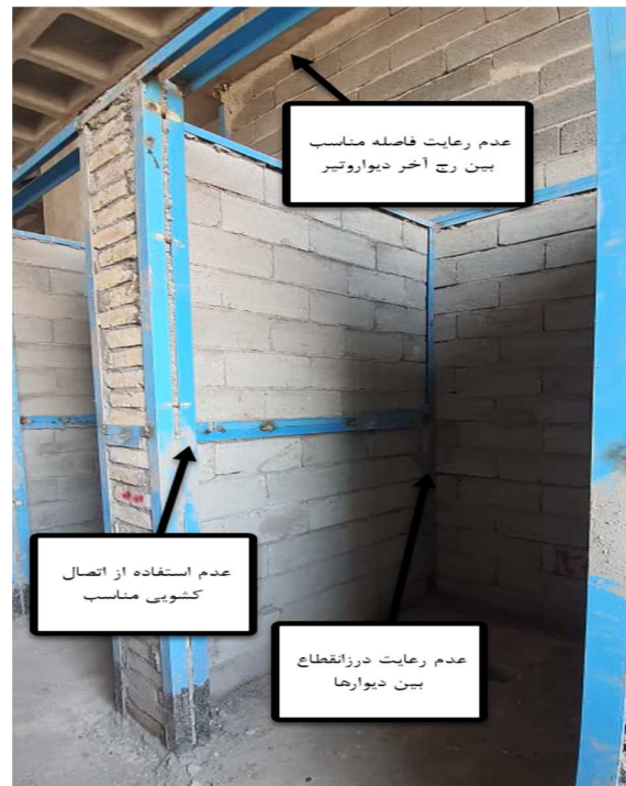
شکل ۴-۲ تکیه گاه های نامناسب در دیوار
