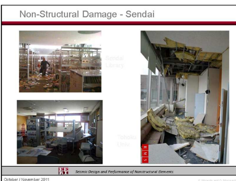
شکل ۱-۶ خسارات گسترده اجزای غیرسازه‌ای در زلزله ژاپن
