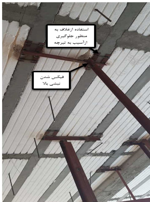
شکل ۴-۷ عدم استفاده از اتصال کشویی برای مهار وادار قائم
