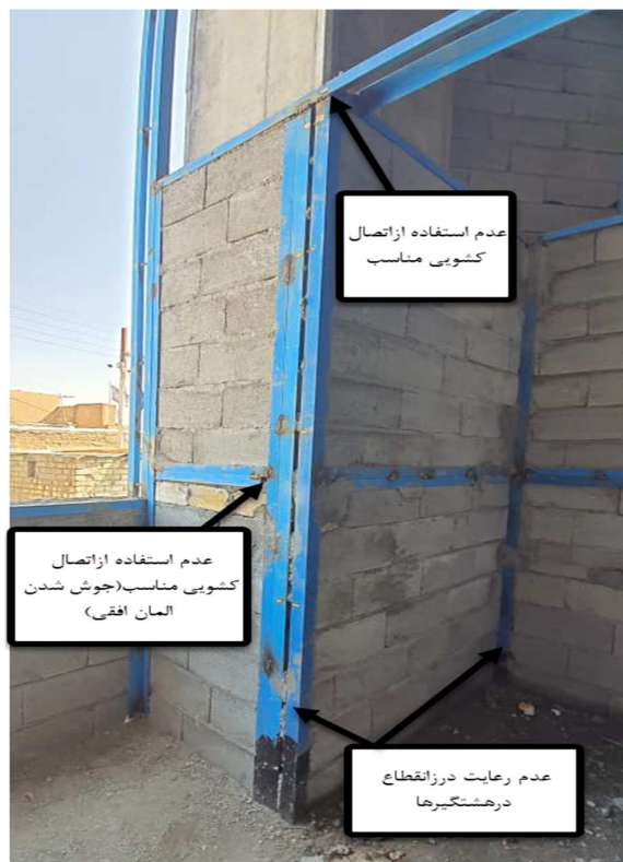
شکل ۴-۹ عدم استفاده از اتصال کشویی برای مهار وادار قائم و افقی
