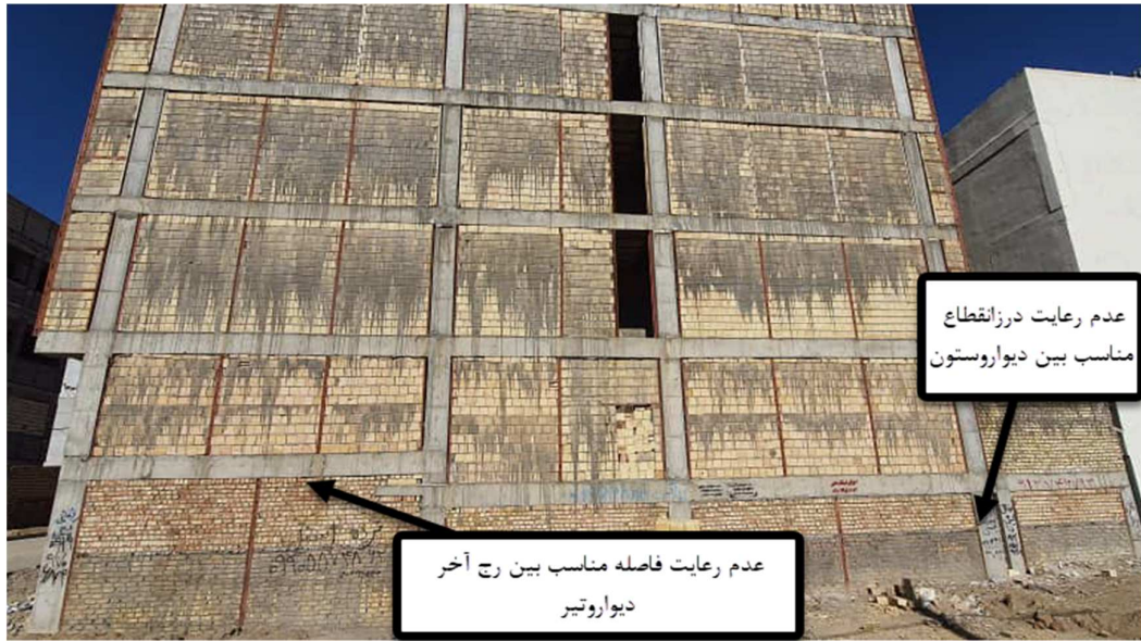
شکل ۴-۵ عدم رعایت جداسازی صحیح دیوار از اطراف
