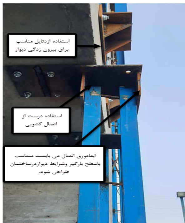
شکل ۱۸-۴ استفاده از تکیه گاه مناسب برای دیوارهای اجراشده خارج تیر تکیه گاهی
