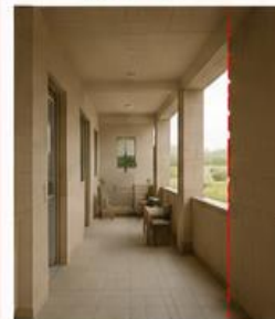
✗ مبنای اشتباه محاسبه از لبه داخلی ایوان
