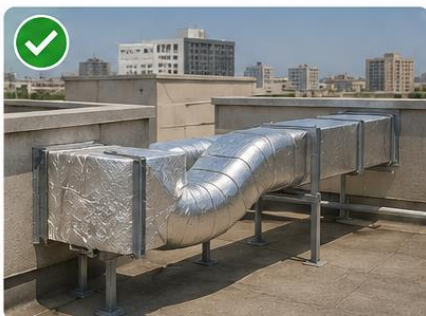
عایق کاری مناسب کانال ها و کوتاه بودن مسیر
