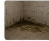
عدم بخاربندی کف
