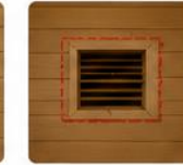
عدم وجود دریچه تهویه مناسب
