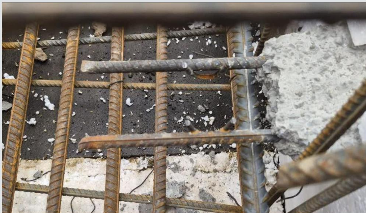
عدم اجرای آرماتور پیوستگی تیرچه ها
